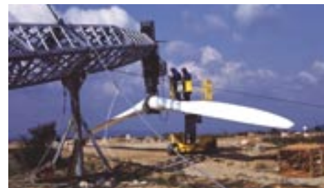
Éolienne à mât basculant : une solution pour les régions sujettes aux cyclones
